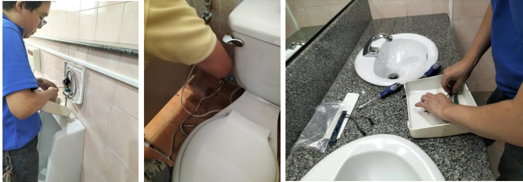
การเปลี่ยนอุปกรณ์ประหยัดน้ำที่เสื่อมสภาพ
