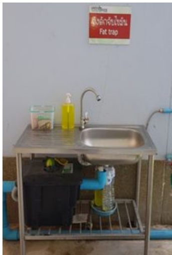
จุดที่ 1 ชั้น 1 อ่างล้างจานใต้บันได
